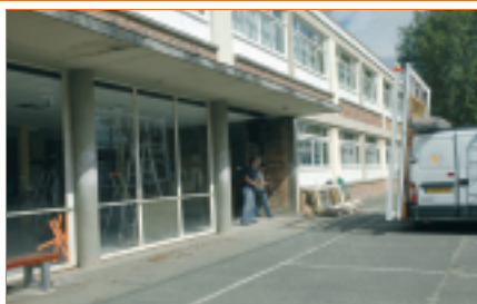
Remplacement de châssis de fenêtres du préau couvert de l'école élémentaire (42 816 euros)
