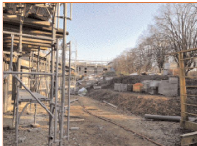
L'emplacement futur de la nouvelle crèche sur le site du pôle seniors actuellement en construction.
