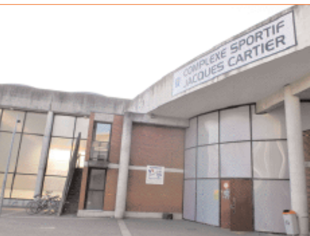
Remplacement des surfaces translucides pour économies d'énergie et adaptation du revêtement de sol de la salle polyvalente à la pratique du roller
