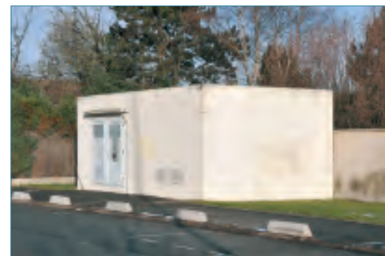
Ce poste lux régulièrement en panne va être supprimé
