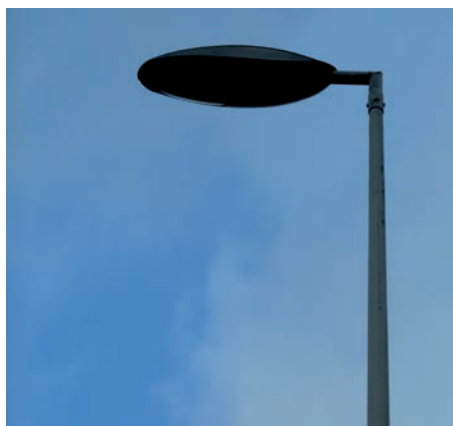
La rénovation de l'éclairage public permet des économies d'énergie, une meilleure sécurité et un plus grand confort visuel.
